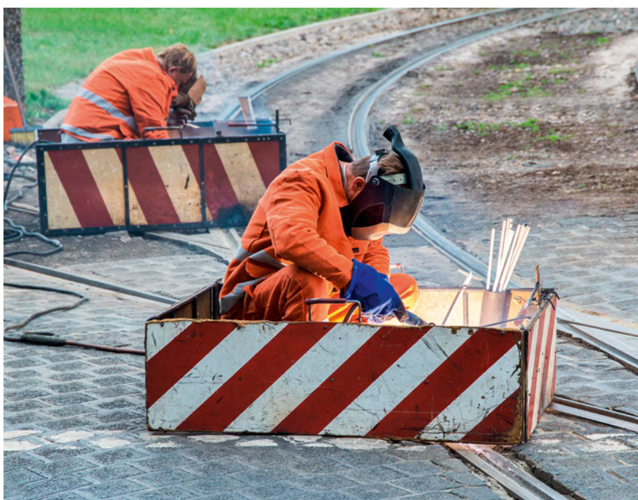
Predictive Maintenance: Die durchgängige Überwachung von Fahrzeug-Systemen und Infrastrukturen erlaubt schnelleres Eingreifen.
